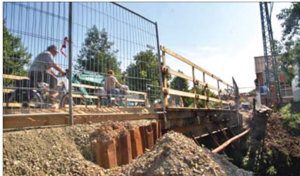
Baustelle am Ortsrand: Noch bis November muss der Verkehr über die Behelfsbrücke rollen. Tietzek
